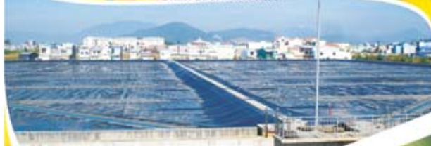
Trạm xử lý nước thải Hoà Cường
